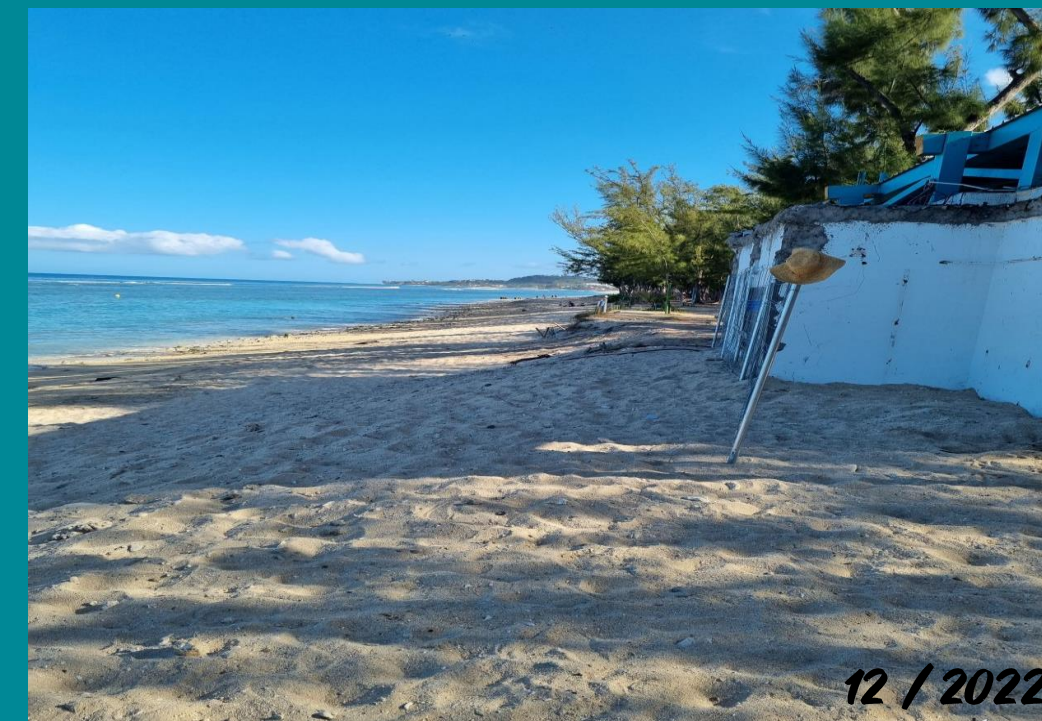
Destruction de \frac{3}{4} du poste MNS
