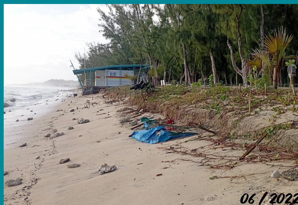
Resistance des casiers et du poste MNS
